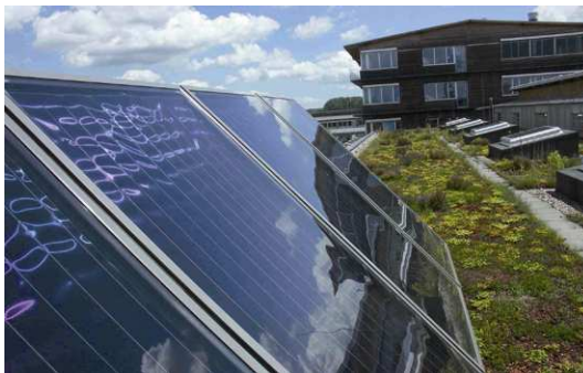
Auf einigen Dächern sind bereits Solaranlagen installiert, wie hier im Umwelttechnologischen Gründerzentrum Augsburg (Bild: UTG Augsburg).
