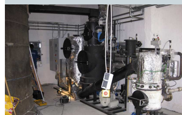
Dieser Holzvergaser wird zusammen mit einer Hackschnitzelanlage künftig vielleicht die Nahwärmeversorgung von Altenmünster gewährleisten. (Bild: Gemeinde Altenmünster)
